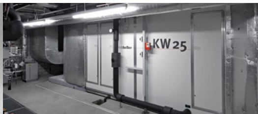
Optimal zur Kühlung von Bürogebäuden sowie Rechenzentren geeignet
